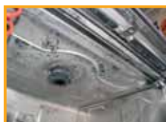
Spülkammer mit starkem Kalkbefall
