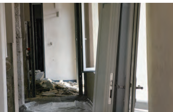
Abb. 3 und 4 – Nach dem Juni-Hochwasser ist – bis auf einen Großteil des „geretteten“ Praxisinventars – alles total zerstört
